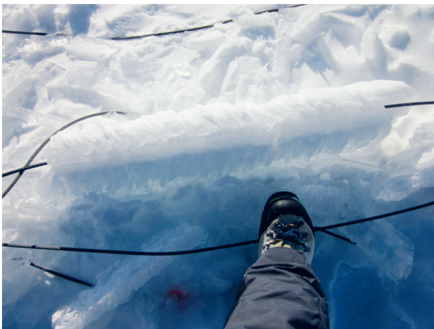
Bild 3 Vereisungsschicht an einem Abspannseil eines unter der Last kollabierten Windmessmastes.
