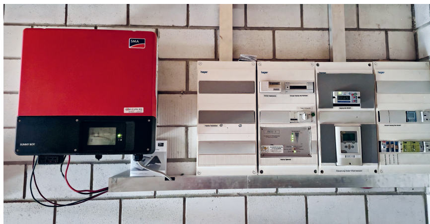
Einer von vier Solarstrom-Wechselrichtern des Hauses.
