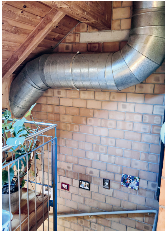
Das Verbindungsrohr zu den Hypokaustböden, die von einem Prinzip der Römer inspiriert wurden.
