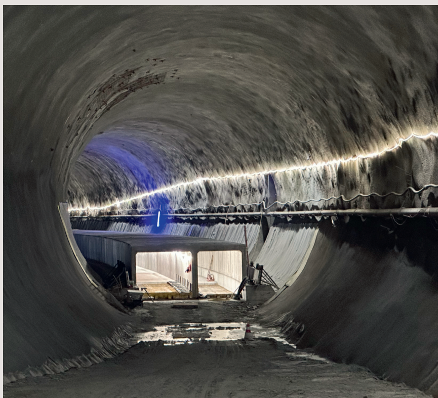
Figure 4 La ligne THT câblée sera installée dans le canal technique de droite.
