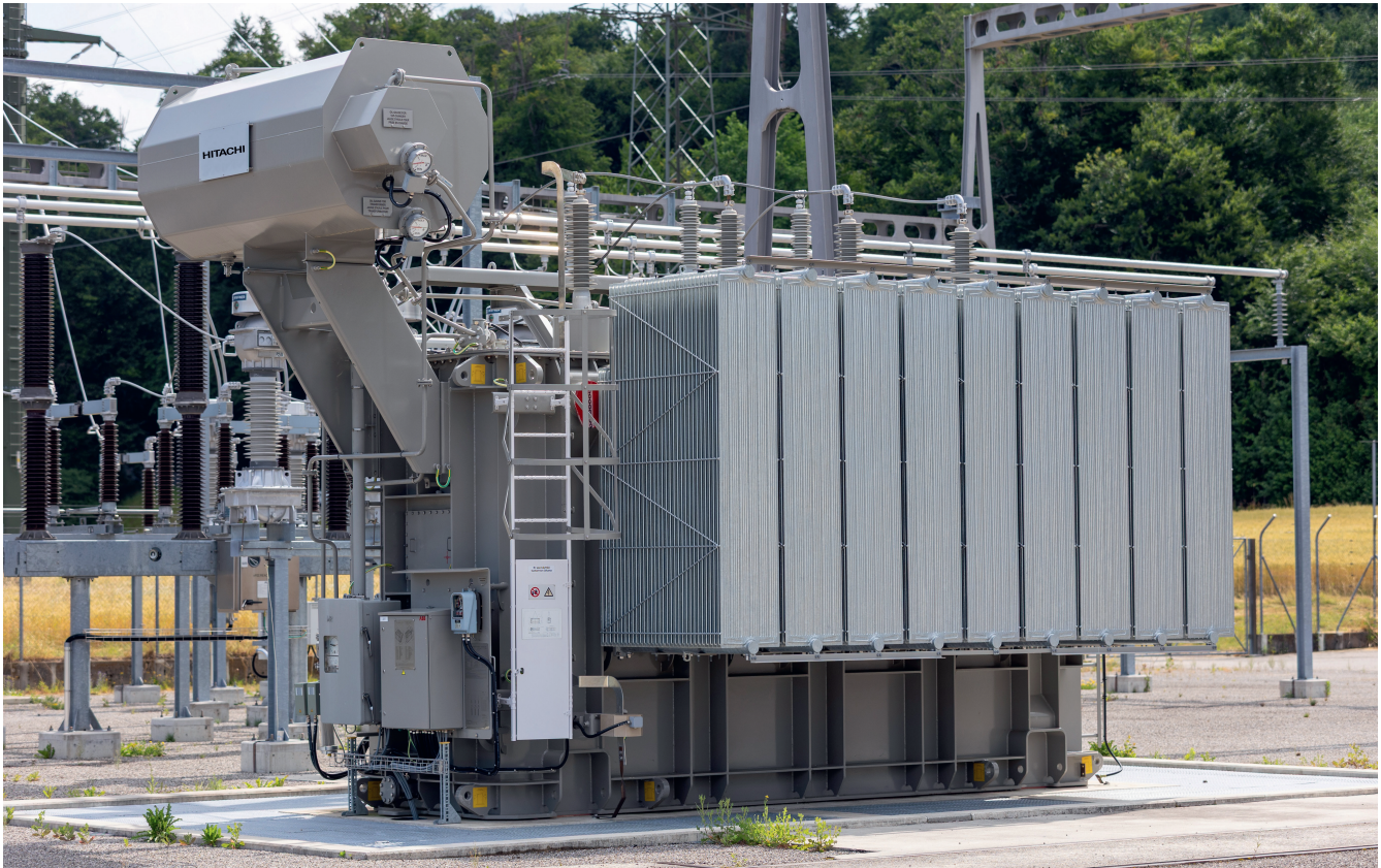
Shunt Reactor 50 MVar, 66 kV, für Groupe E, in Monteynan, Schweiz.
