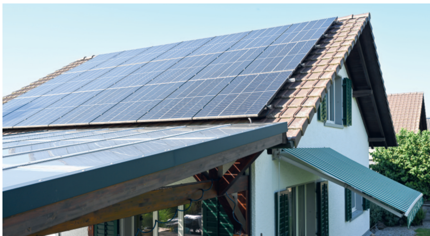
Intégration de l'énergie solaire dans les bâtiments résidentiels : un pilier de la transition énergétique.
