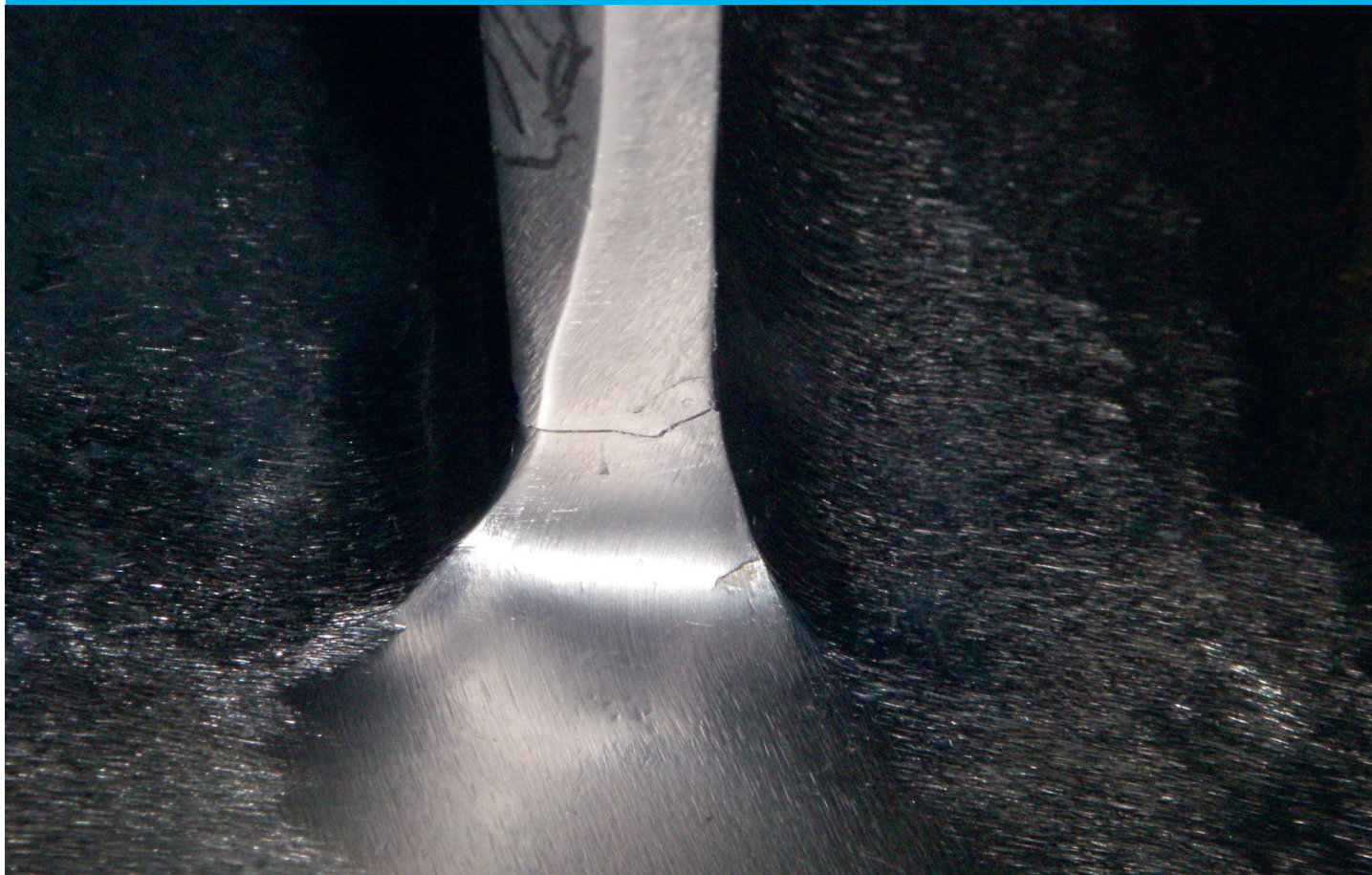
Ermüdungsrisse infolge hochfrequenter Wechselbeanspruchung.
