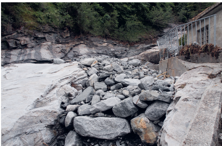
Die Wasserfassung von Soveneda bei Piano di Peccia nach der Überschwemmung.
