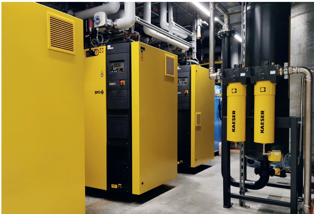
Neues Druckluftsystem bei Hamilton Bonaduz AG.
