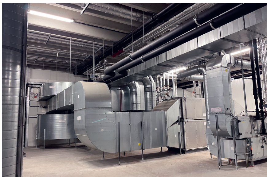
Bild 2 Belüftungssystem bei Coca-Cola HBC Österreich.
