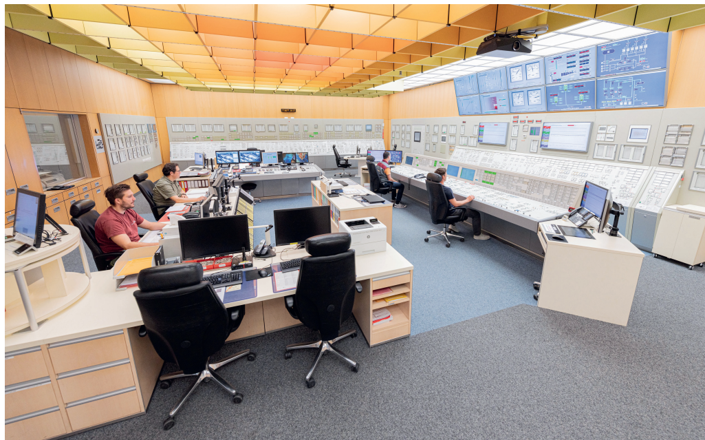
Salle de commande de la centrale nucléaire de Gösgen.
