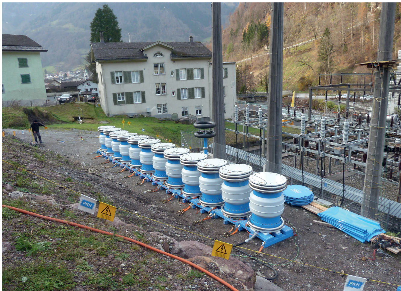
Kabelprüfung an einem 110-kV-Kabelsystem.
