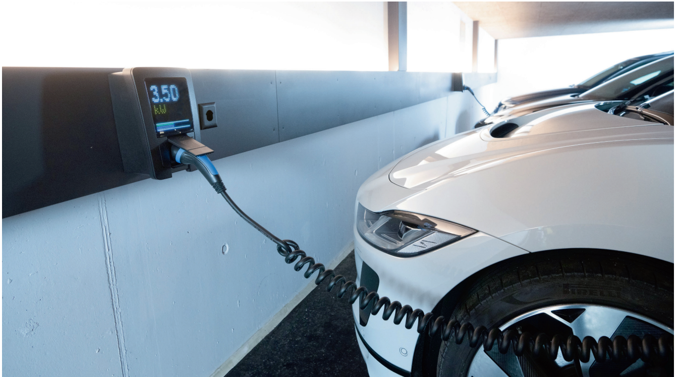
Pico-Ladestationen in der Einstellhalle.
