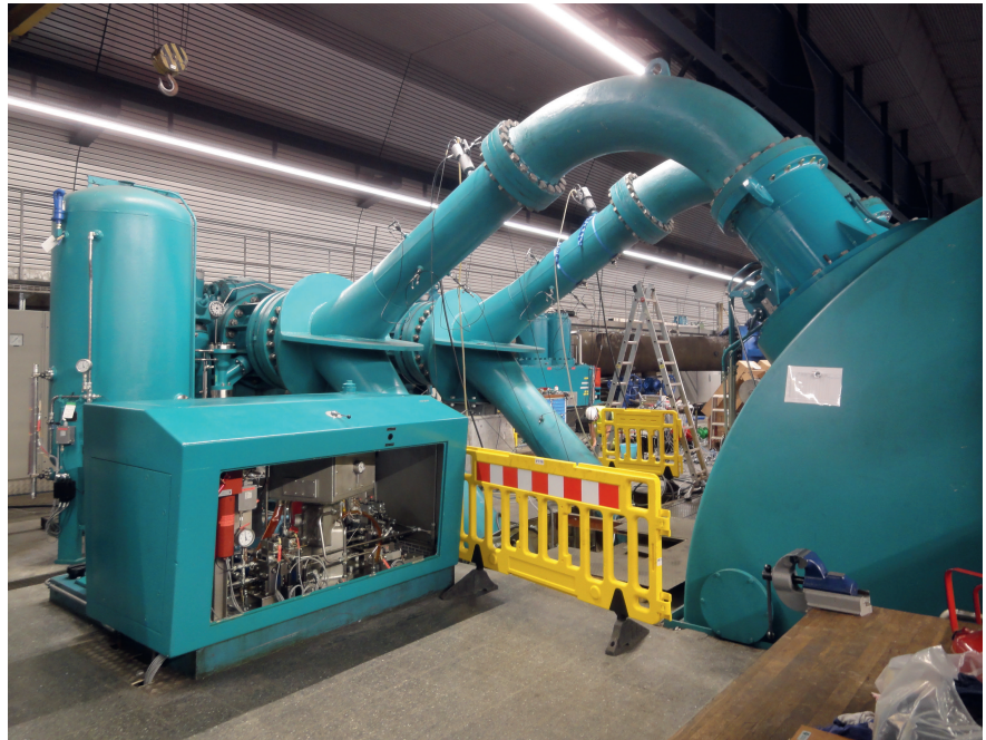
Figure 1 Répartiteur du groupe 3 de la centrale de Veytaux I instrumenté durant la campagne de mesure de performances par la méthode thermodynamique.
