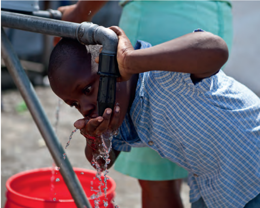
Mettre en place un pompage solaire pour puiser de l'eau potable en profondeur : un des nombreux domaines d'action d'Électriciens sans frontières.
