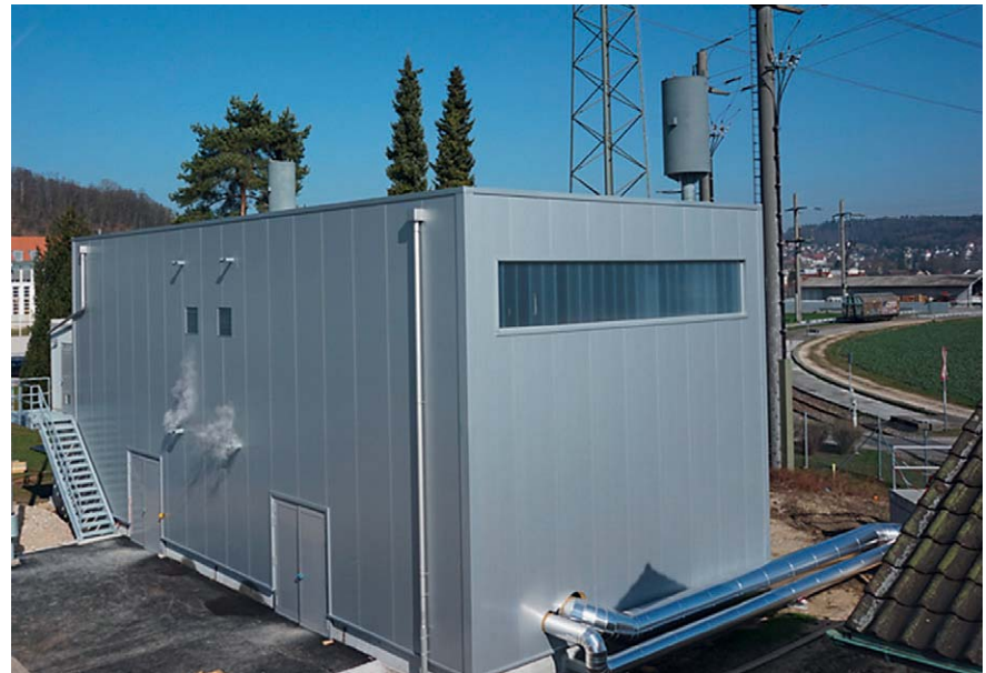
Die Power-to-Heat-Anlage in Niedergösgen hat eine Leistung von 22 MW.
