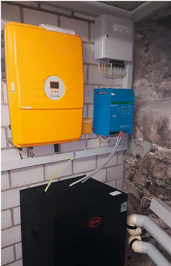
Energiespeicher im Quartierstrom-Netz: Insgesamt sind sieben Speicher mit einer Gesamtkapazität von 80 kW in den lokalen Strommarkt eingebunden.
