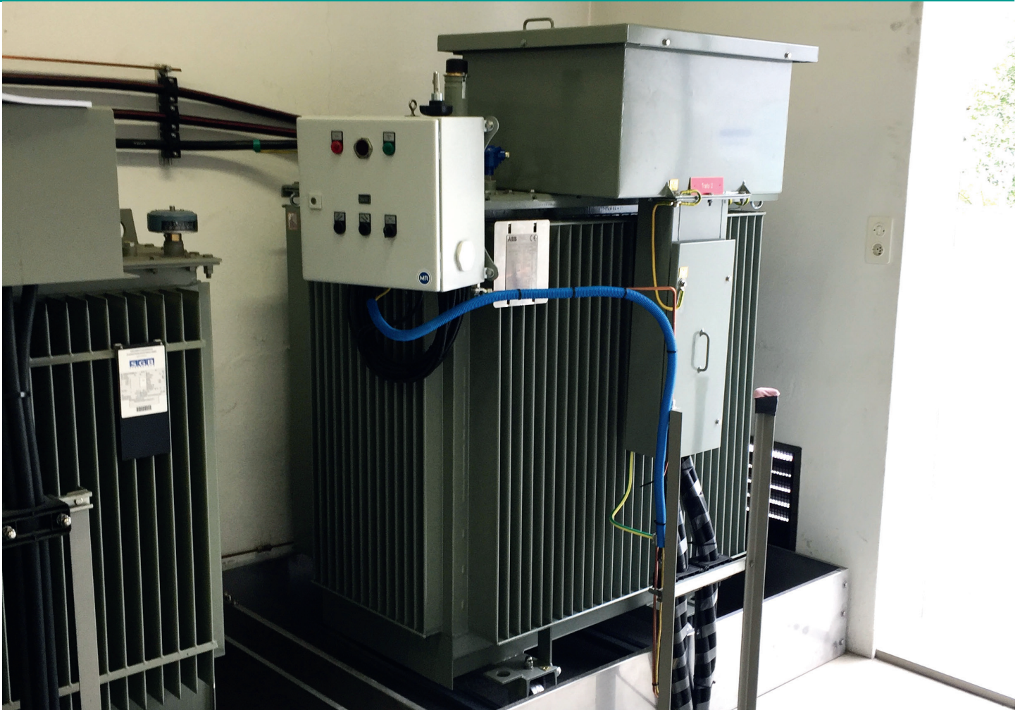
Im Vein-Projekt eingesetzte regelbare Trafos.
