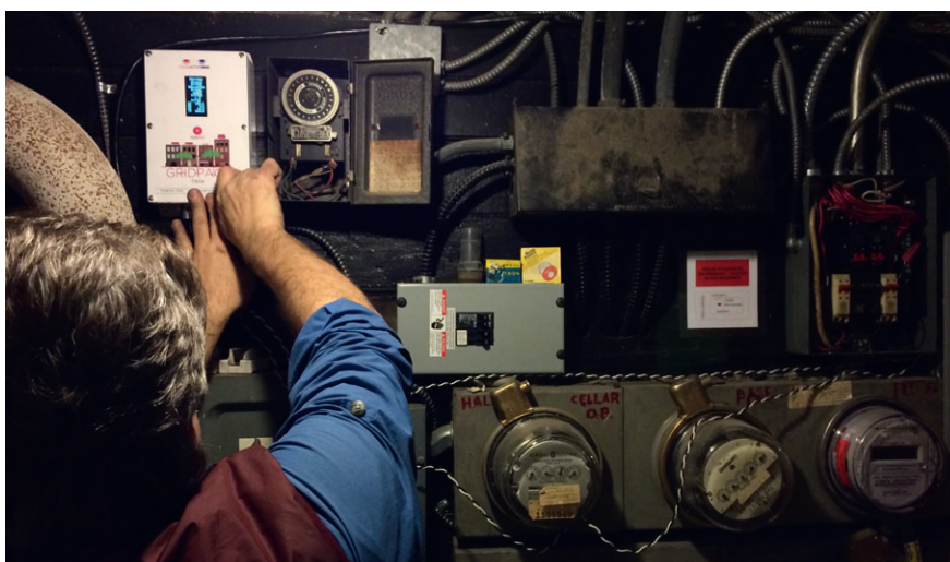
Mit dieser kleinen Box können die Teilnehmer ihren überschüssigen Strom in das lokale Netz einspeisen und hierfür eine Vergütung von den Abnehmern erhalten.
