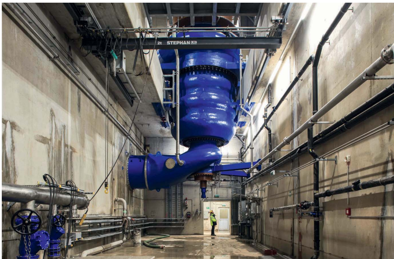
Pompe à 5 étages (500 t/min) de 120 MW de la nouvelle centrale FMHL+.
