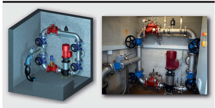
Figure 5 Implantation de la PAT sur le site pilote à Savièse.
