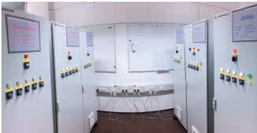
Bild 3 Hardware-in-the-Loop-Testlabor in der Woodward Kempen GmbH für unabhängiges (automatisiertes) Testen von Wandler-, Generatoren- und Netzkonfigurationen.
