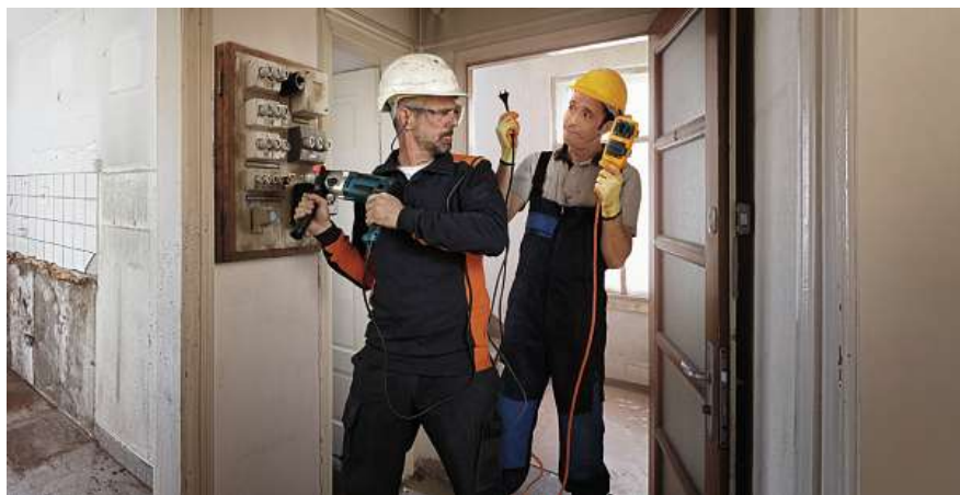
Les ensembles d'appareillage peuvent renfermer de l'amiante.
