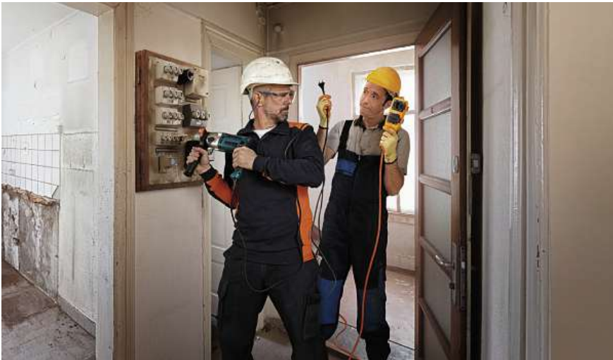
In alten Schaltgerätekombinationen ist oft Asbest enthalten.
