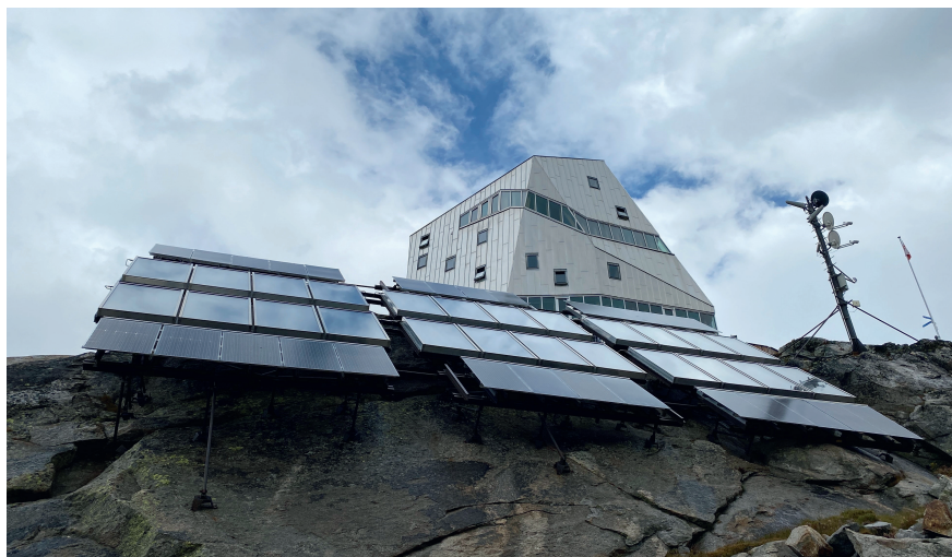
Bild 4 Sonnenkollektoren (zwei mittlere Reihen) liefern Wärme für Heizung und Warmwasser. 2013 wurden zudem zusätzliche PV-Module installiert, um den Strom-Deckungsgrad zu erhöhen.
