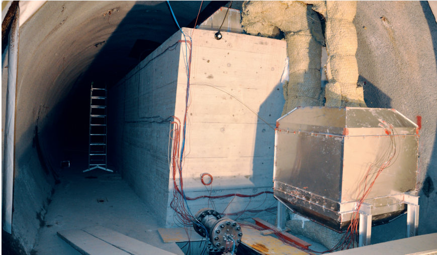
Sensibel-latenter thermischer Speicher in der Pilotanlage bei Pollegio. Links ist der mit Kieselsteinen gefüllte sensible Speicher, rechts der latente Speicher zu sehen. Der sensible Speicher ist 3,1 m hoch, 9,9 m lang und 4 m breit. Der latente Speicher ist etwa 1,5 m hoch, lang und breit.
