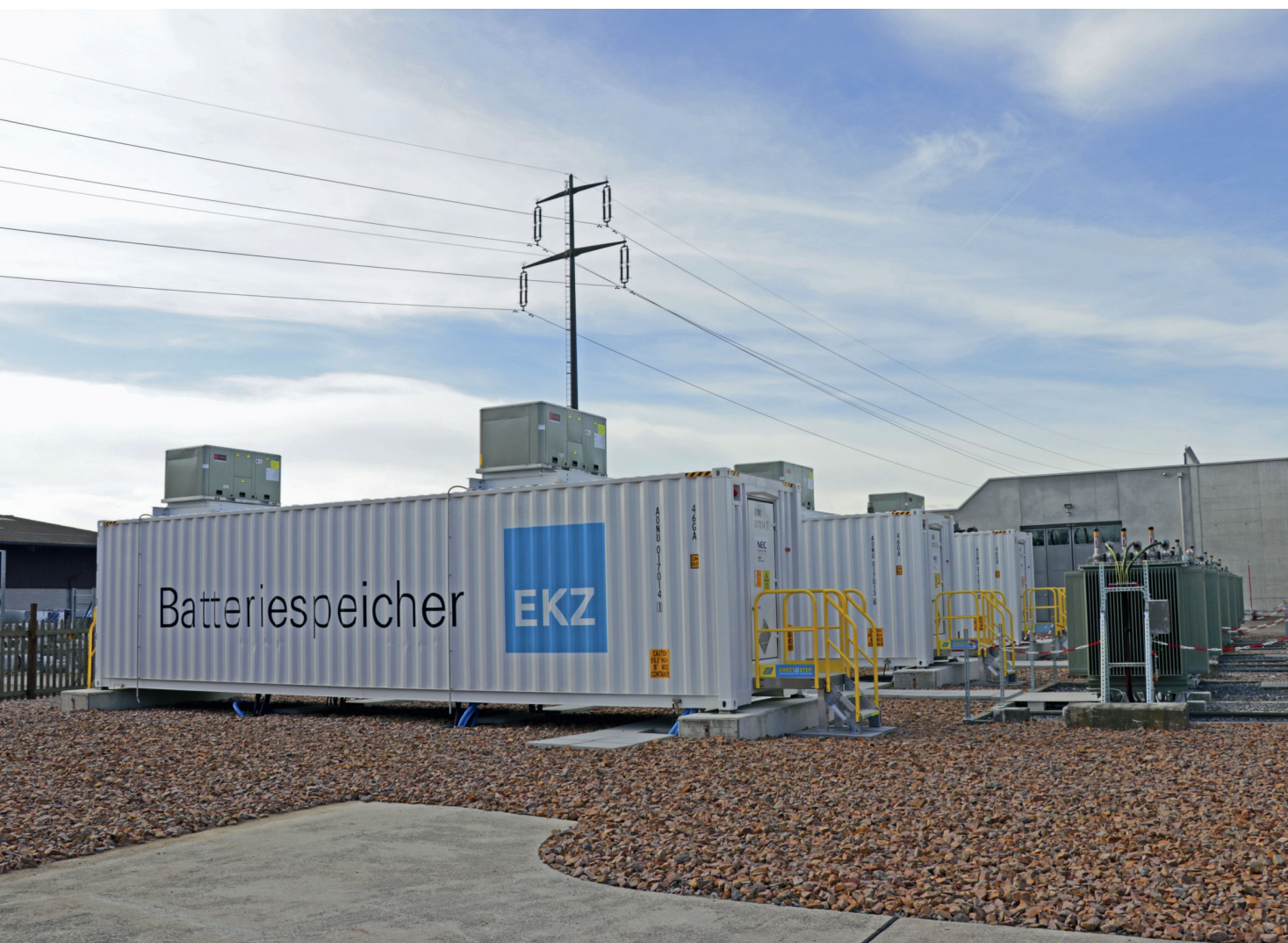
Der Batteriespeicher in Volketswil hat eine maximale Leistung von 18 MW und kann 7,5 MWh speichern.
