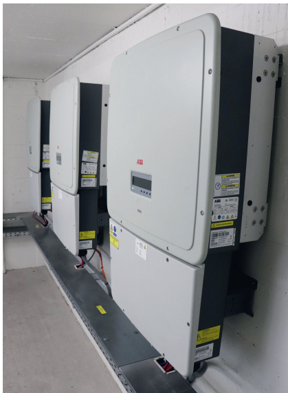
Bild 1 Die PV-Wechselrichter bei Camille Bloch können auch zur Kompensation von Blindleistung eingesetzt werden.
