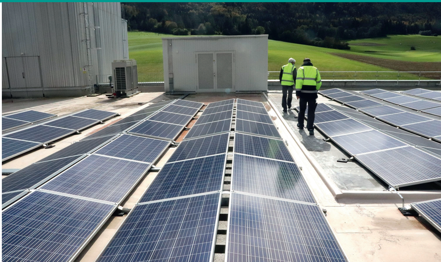
PV-Anlage bei Camille Bloch.
