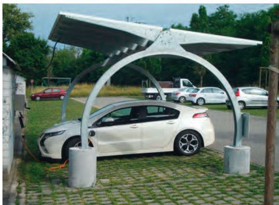
L'ombrière photovoltaïque de la BFH-TI de Berthoud.
