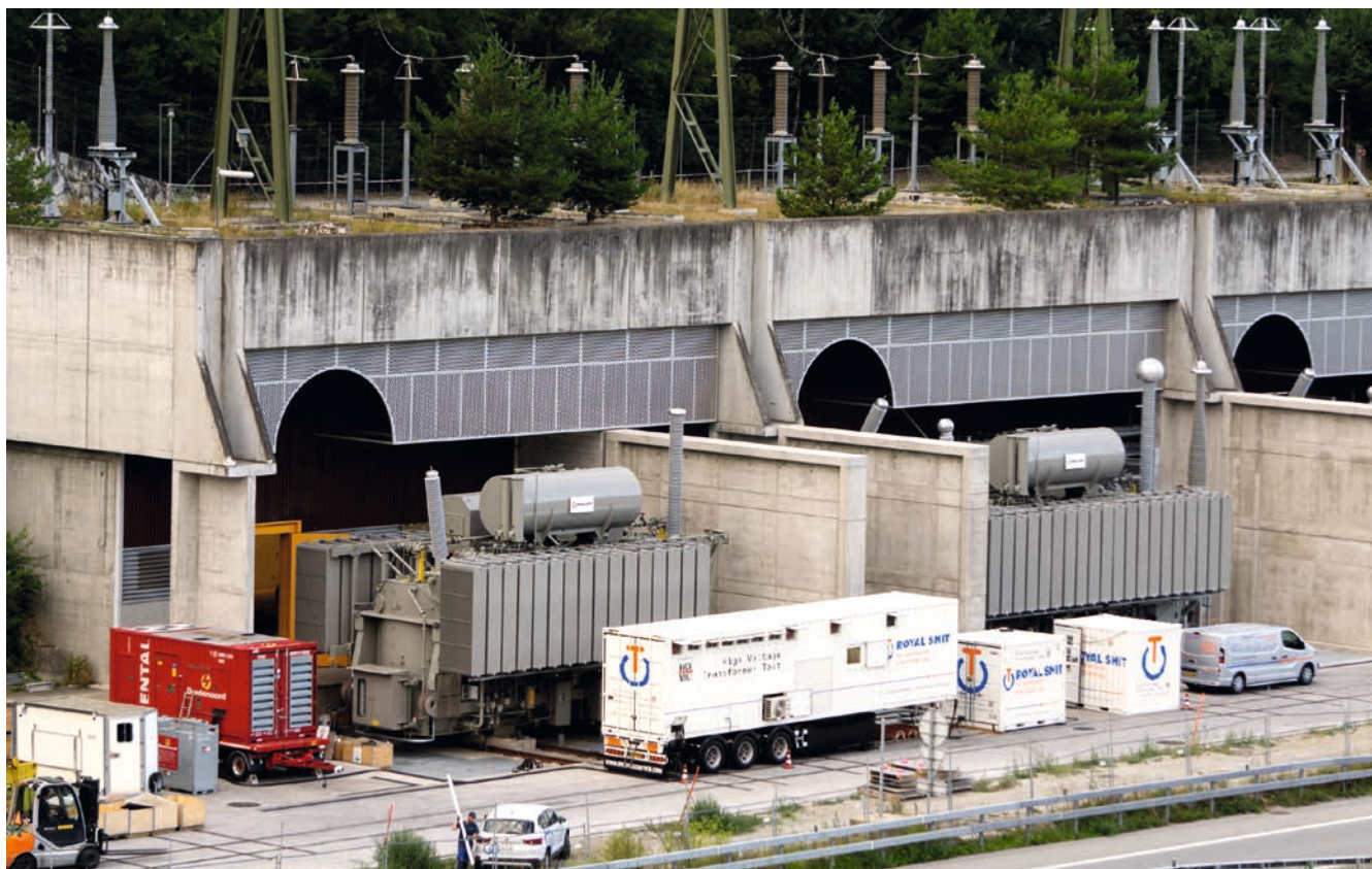
Phasenschieber-Transformator von Swissgrid in Chippis.
