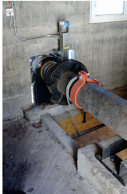
Ein Stahlseil betätigt die Antriebsachse der Stauklappe.
