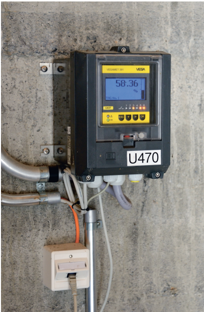
Die Öffnung der Stauklappe wird mit einem digitalen Weggeber überwacht.
