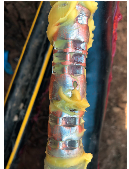
Bild 1 Teilentladungen können beispielsweise durch die Verwendung eines falschen Presswerkzeugs entstehen.
