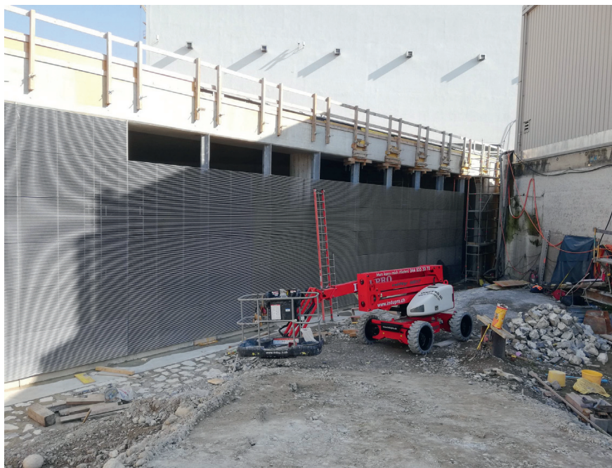
Bild 6 Das Limmat-Kraftwerk in Dietikon verfügt seit 2019 über den grössten Horizontalrechen in der Schweiz mit einer Rechenfläche von über 200 m 2 und einem Stababstand von 20 mm. Der Bypassingang befindet sich rechts beim Baugerüst.
