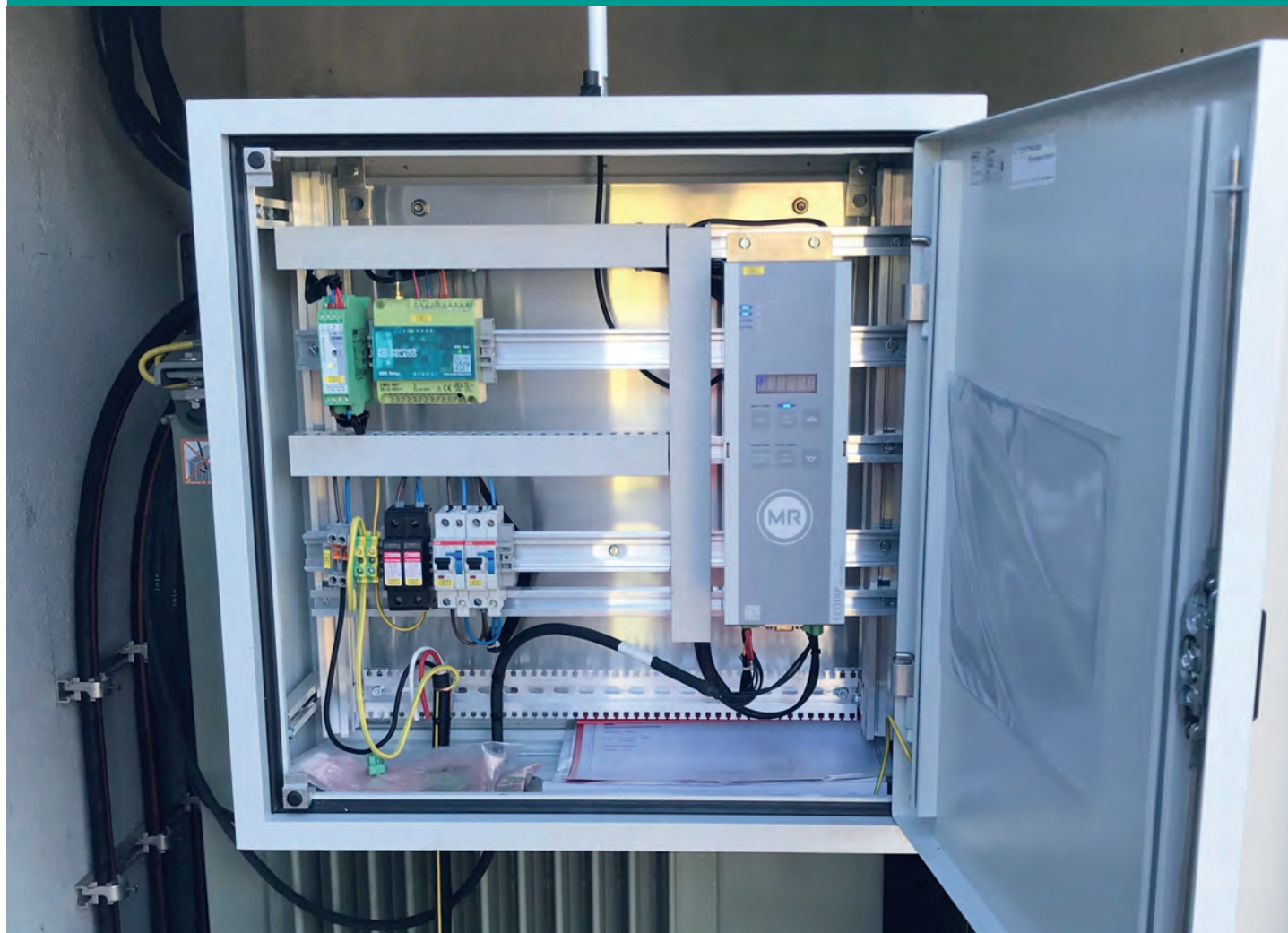
Commande d'un transformateur local réglable.
