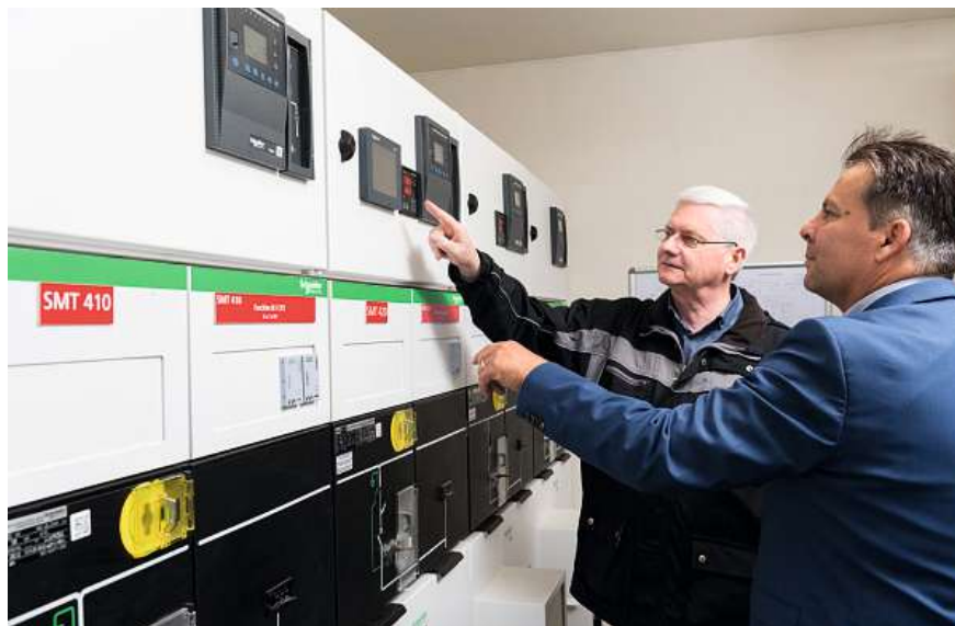
Die Daten und Zustandsangaben der Anlagen können sowohl vor Ort ...
