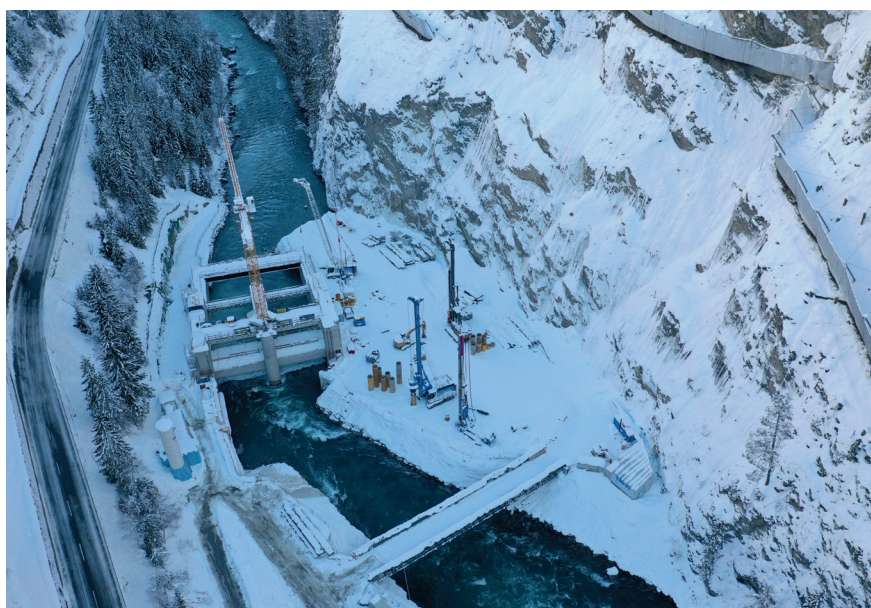
Bild 2 Der Betrieb der Wehrbaustelle muss bei schneereichen Wintermonaten eingestellt werden, weil die mit Schnee verfüllten Steinschlagschutznetze die Sicherheit auf der Baustelle nicht mehr garantieren können.
