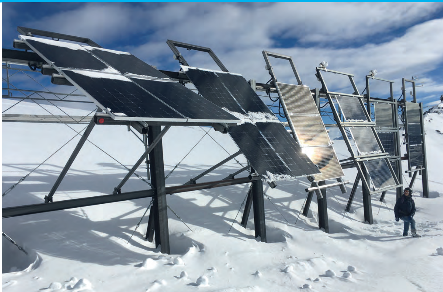
Installation photovoltaïque réalisée pour des essais à 2500 m d'altitude, sur le domaine skiable de Parsenn à Davos.
