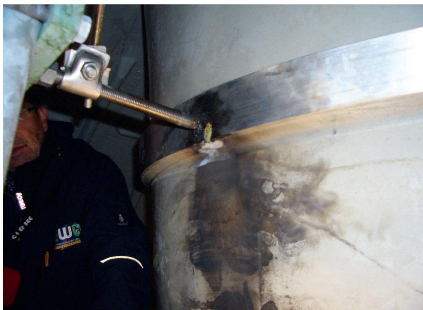
Bild 5 Folgen eines Blitzschlags auf dem Schleifring des Rotorblatts einer Windanlage auf dem Gütsch bei Andermatt.
