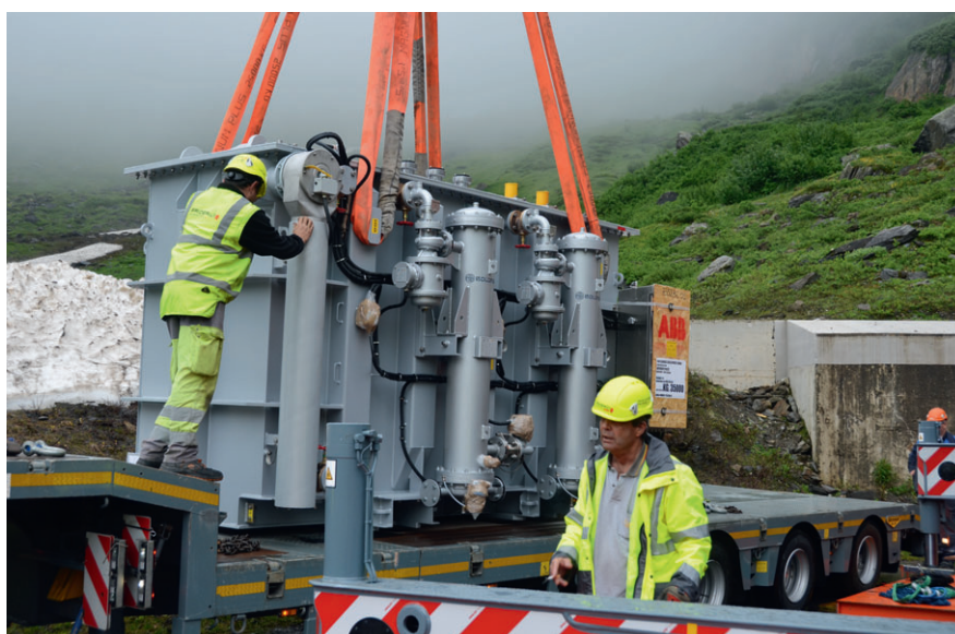
Bild 4 Einbau des neuen, wassergekühlten 20-MVA-Transformators, der sowohl die elektrische Energie der Wasserkraft als auch der Windkraft ins Mittelspannungsnetz einspeist.
