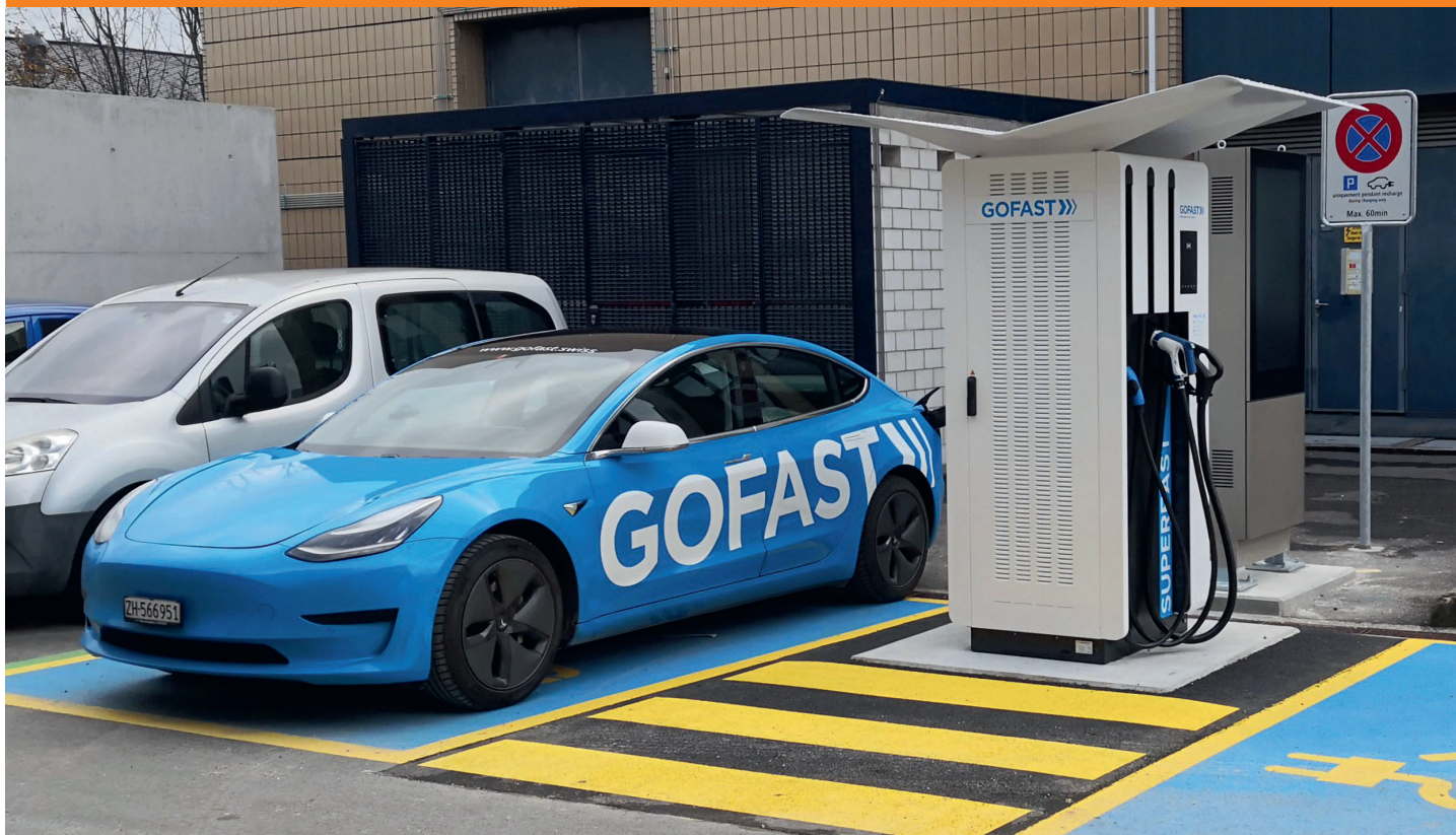
Station de recharge pour deux voitures électriques sur le campus de l'EPFL.
