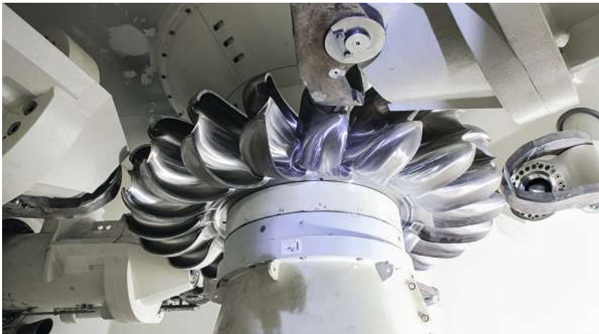
Figure 4 Turbine de 120 MW de FMHL+, projet pilote de la Maintenance 4.0.
