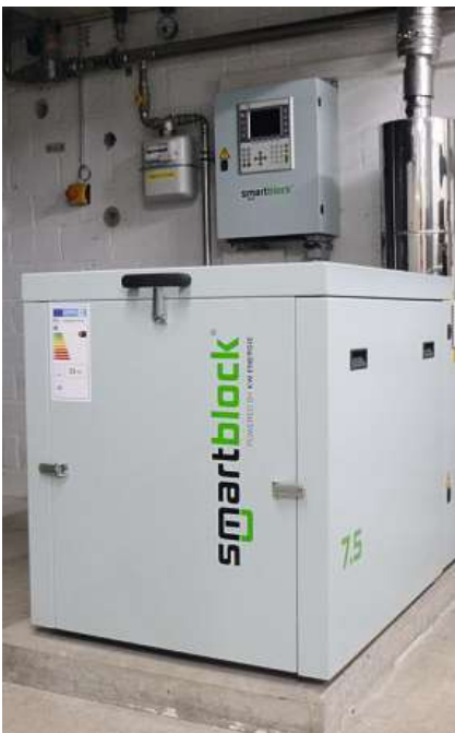
Bild 5 Smartblock-BHKW mit 7,5 kW elektrischer und 22,1 kW thermischer Leistung, im Heizraum inklusive Abgaskondensator.
