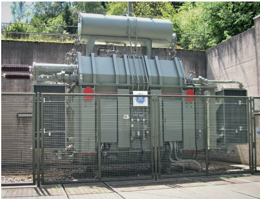
Bild 3 Neuer Blockumspanner 2 AC 10,75/110 kV, 16,7 Hz, Nennleistung 100 MVA, Masse in betriebsbereitem Zustand: 220 t.
