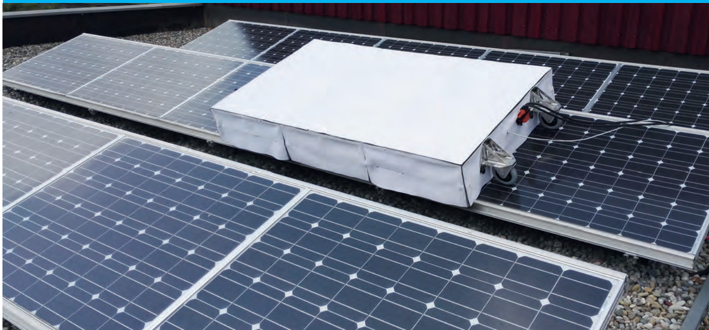
Der Portable LED-Flasher im Einsatz auf einer PV-Anlage in Wallisellen. Der PLF wird mit den seitlich angebrachten Rollen über die Module gerollt und die Module müssen nicht demontiert werden.
