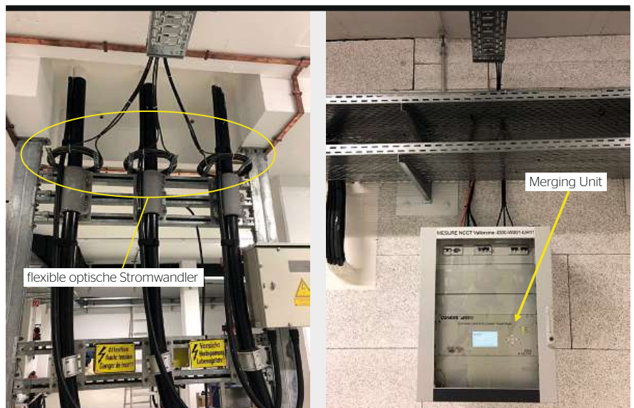
Bild 5 Montage-Setup des flexiblen optischen Stromwandlers im Unterwerk Châtellard.
