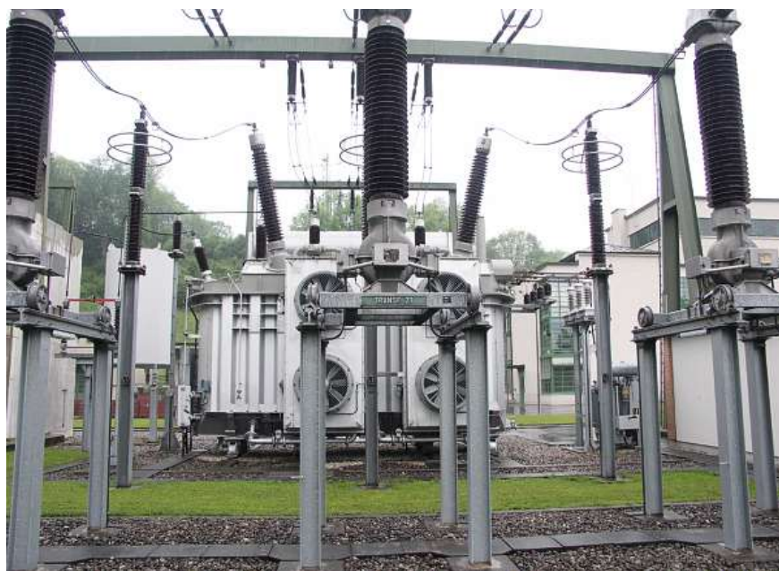
Einer der beiden Transformatoren im Unterwerk Winkeln.
