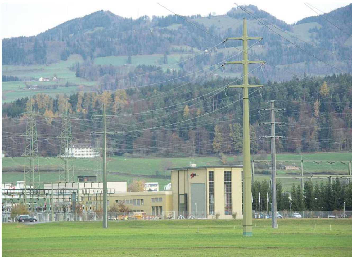
Das Unterwerk Grynau.
