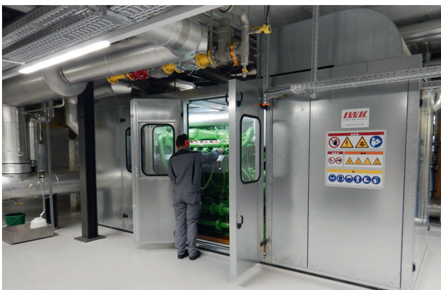
Bild 4 Das Blockheizkraftwerk der ARA Morgental in Steinach (SG) produziert aus Klärgas elektrische Energie. Die ARA nimmt am Alpiq-Regelleistungspool teil.
