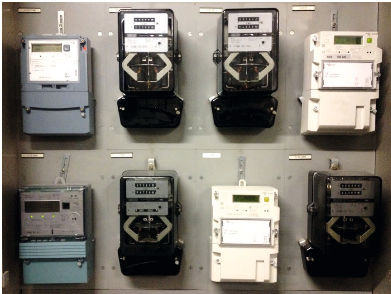
Zählerkasten eines ZEV.
