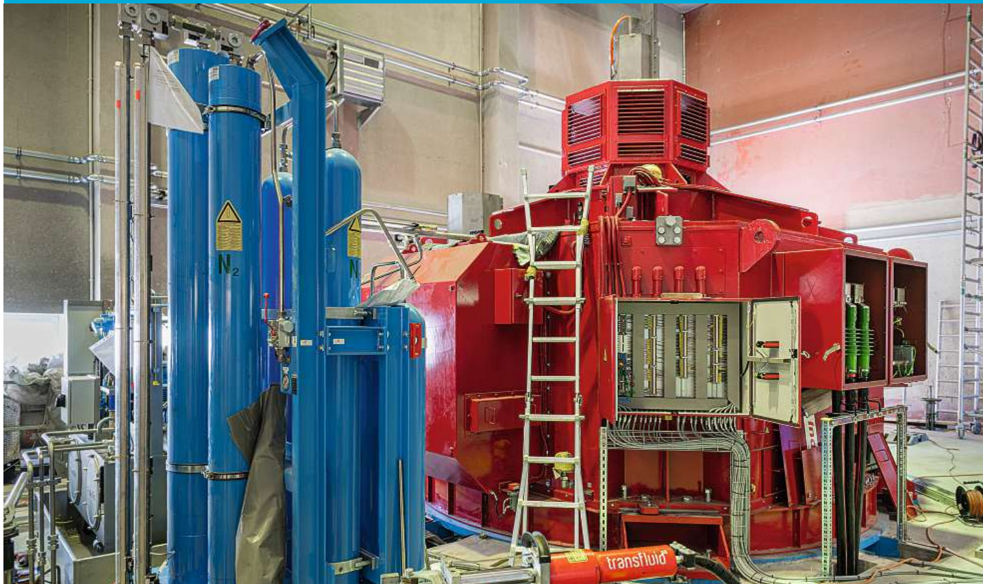
Einer der neuen Generatoren im Kraftwerk Dietikon.
